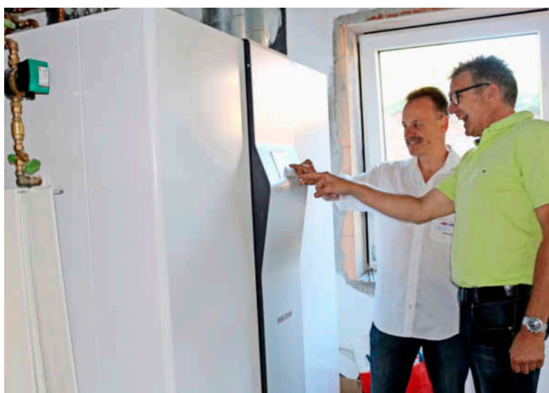
»Effizienter geht es nicht«, sagt Heizungsinstallateur Arno Schreier, der mit Energieberater Jürgen Leppig die eingebaute Luft-Wasser-Wärmepumpe begutachtet.
