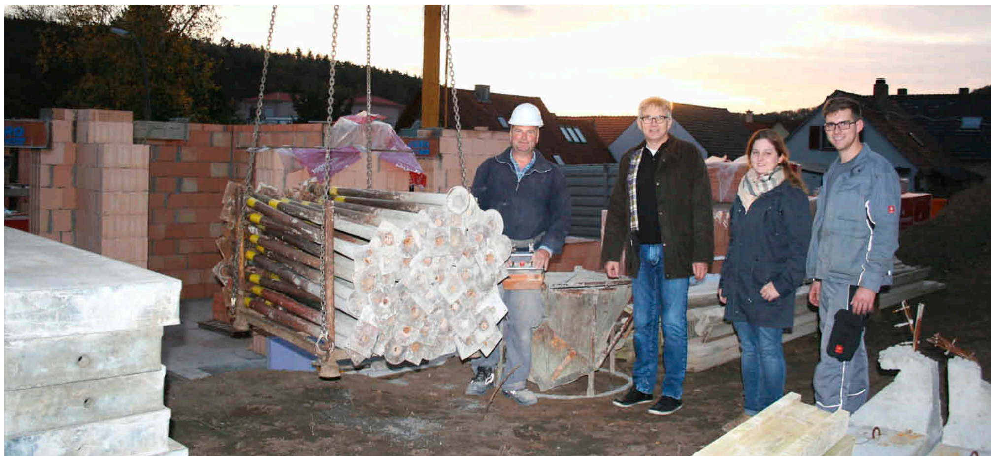
Das Abenteuer Hausbau beginnt: Das junge Paar Karolina Lorenz und Simon Franz mit Energieberater Jürgen Leppig Ende letzten Jahres beim Rohbau.
