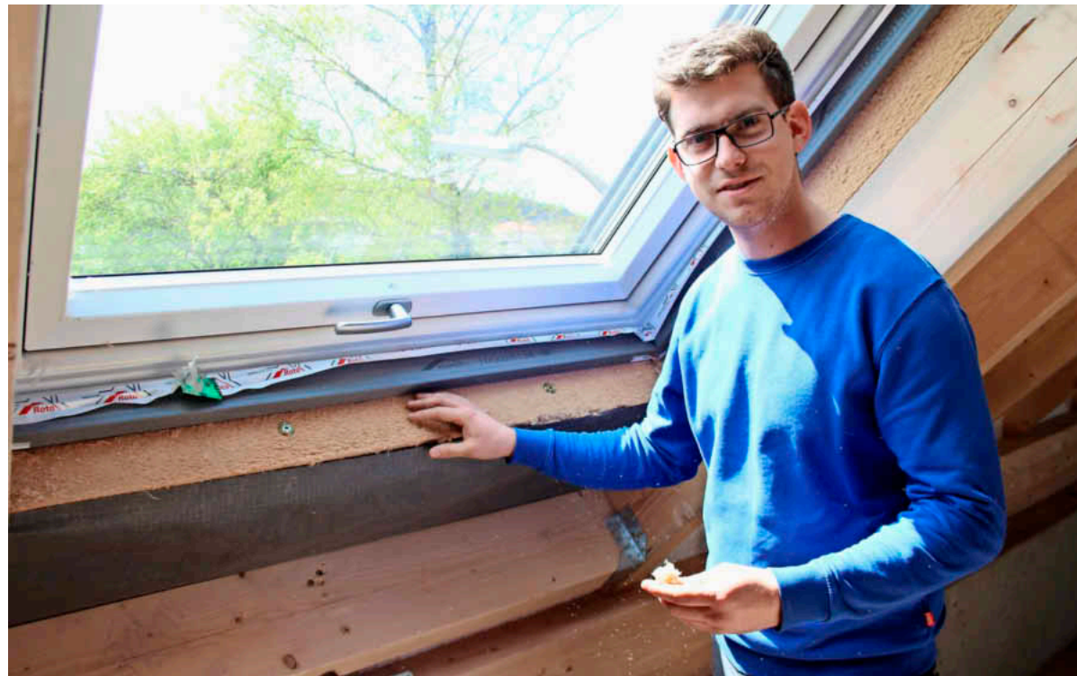
Stolz auf jeden Baufortschritt: Simon Franz vor den dreifach verglasten Fenstern seines 40-Plus-Hauses.
