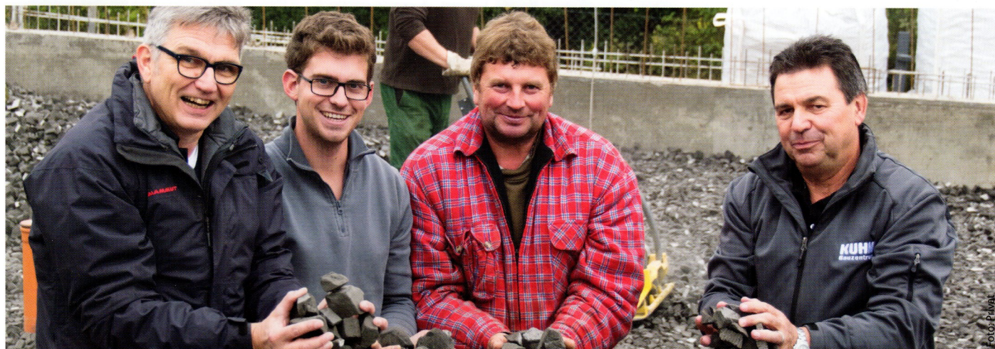
Glas-Schotter unter der Bodenplatte, Dreifach-Fenster und mit Perlit gefüllte Mauerziegel machen ein Haus im fränkischen Marktheidenfeld zum zukunftsfähigen Niedrigstenergiehaus.
